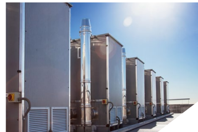
ΘΕΡΜΑΝΣΗ, ΕΞΑΕΡΙΣΜΟΣ ΚΑΙ ΚΛΙΜΑΤΙΣΜΟΣ
